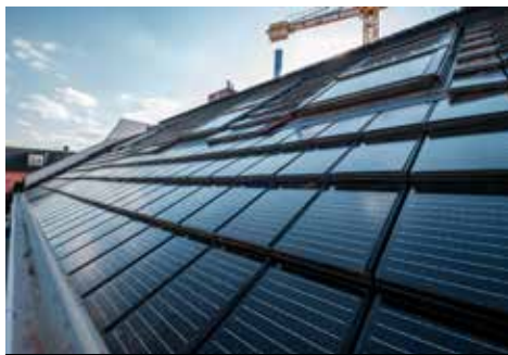
Komplettbelegung mit PV Fotografie Franz Kimmel
